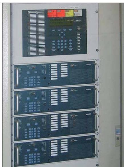
Beispiel für Schaltschrankeinbau
